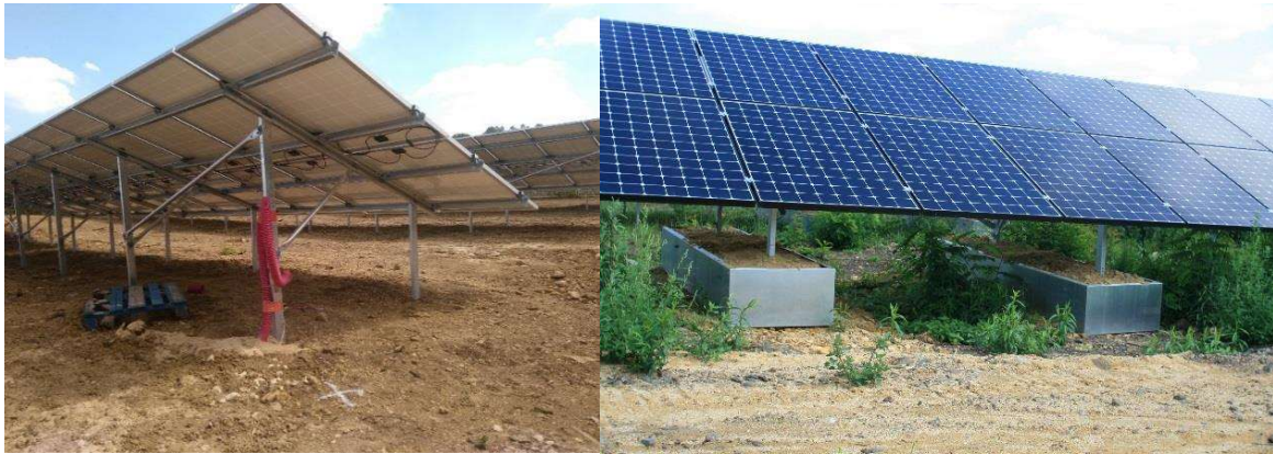
Centrale photovoltaïque de Boulogny – fixation sur pieux – Source : Total Quadran
