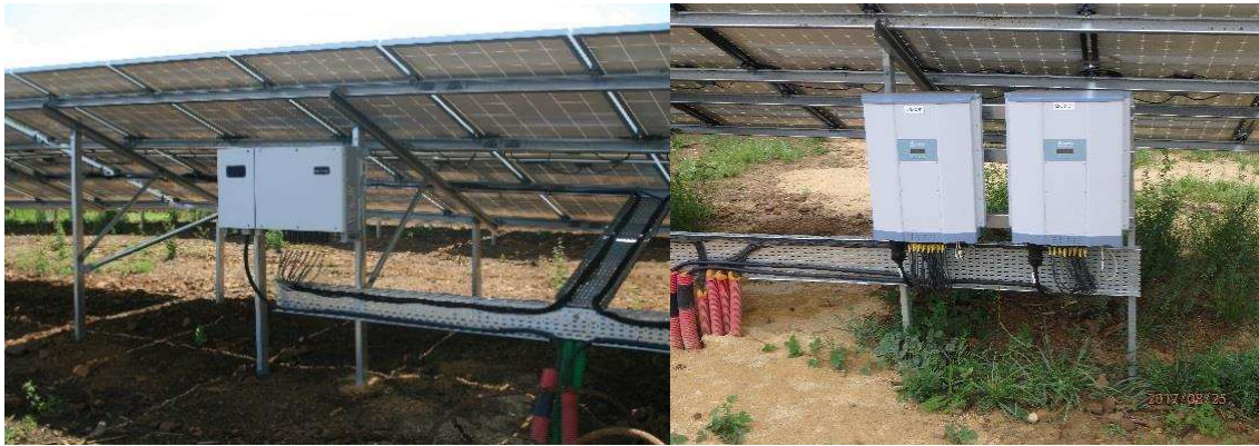
Figure 4 : Exemples d'onduleurs décentralisés – Centrale de Piennes-Joudreville (54) - (Source : Total Quadran)
