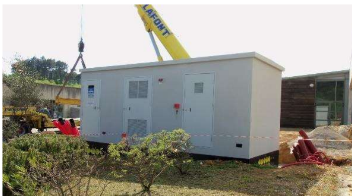
Photo de l'installation du poste de livraison centrale solaire du pôle mécanique (Grand Alès) – (Source : TotQuadran)
