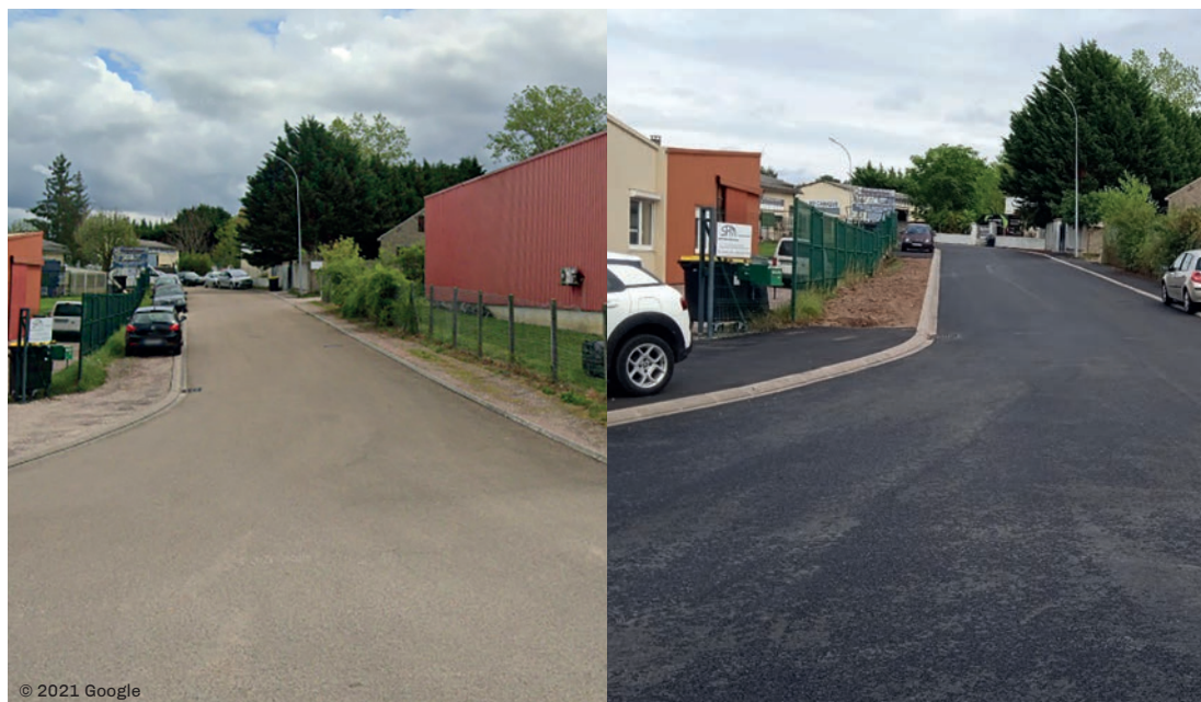
Rue Arnorld-Marti à Saint-Georges-sur-Baulche avant (à gauche) et après les travaux de voiries (à droite).
