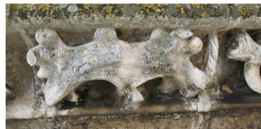
Pierre sculptée dégradée cathédrale d'Auxerre, avant restauration
